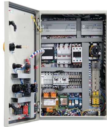
Quadro elettrico di comando. Electric control board. Cadre électrique de commande. Elektrische Steuerschalttafel.
